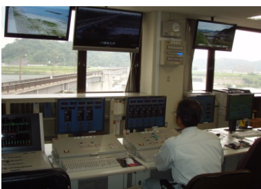
日野川堰の操作
