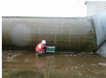
日野川堰の点検保守
