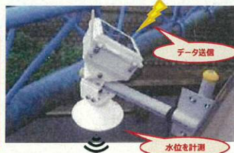
危機管理型水位計の設置例
