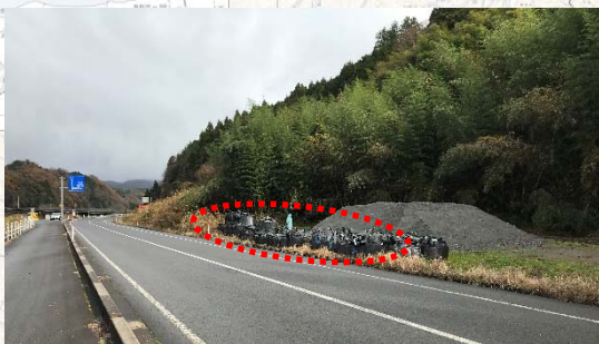
＜江府町管内対応用土のう仮置場＞
