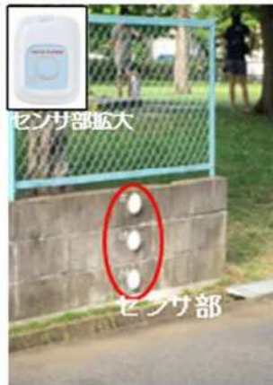
光陽無線（株） ／太陽誘電（株）
