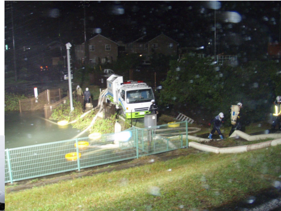
例：排水ポンプ車運転状況（平成23年9月）
