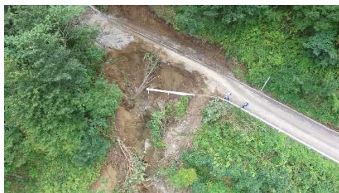
崩壊した道路の被害状況調査(岩泉町)
