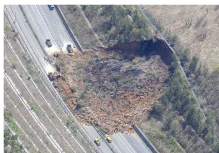
土砂崩落(大分道由布岳PA付近)
