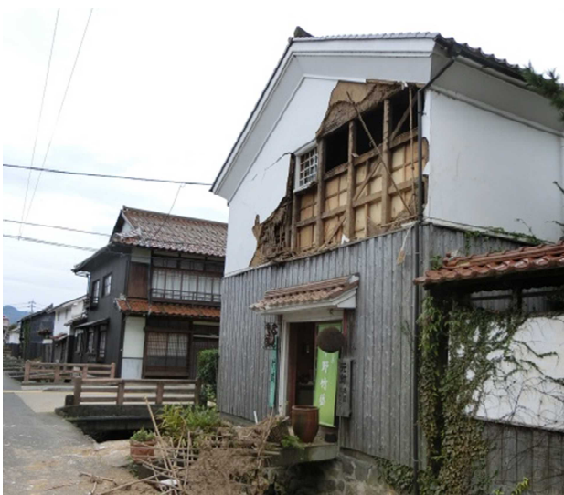
白壁土蔵群における外壁の崩落状況(鳥取県倉吉市)
