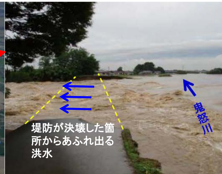
被災状況(拡大写真)
