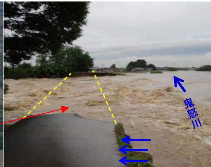
被災状況(拡大写真)
