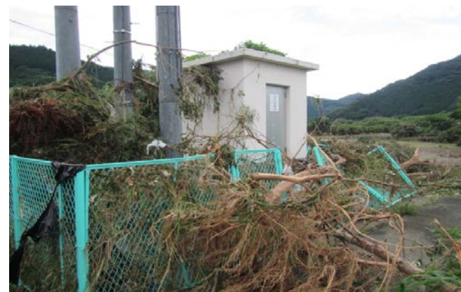
放流警報設備の浸水後の状況
