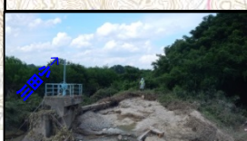
【表法崩れ】L=70m 小田川右岸4k400付近
