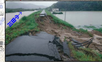
【裏法崩れ】L=30m 小田川右岸0k600付近
