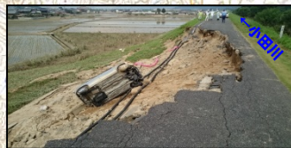
【裏法崩れ】L=80m 小田川左岸4k200付近
