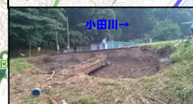
【裏法崩れ】L=16m 小田川右岸4k200付近
