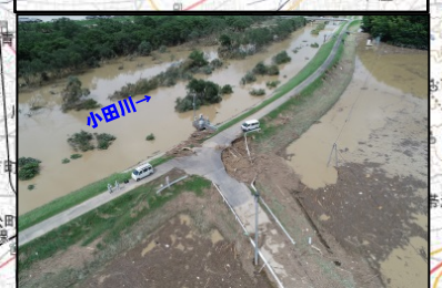
【裏法崩れ】L=1,000m(点在) 小田川右岸2k800～3k800付近
