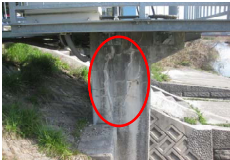
21 樋門門柱のクラック発生状況
