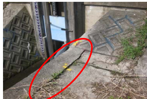
22 取り付け護岸の段差発生状況
