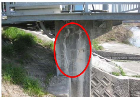
樋門門柱のクラック発生状況
