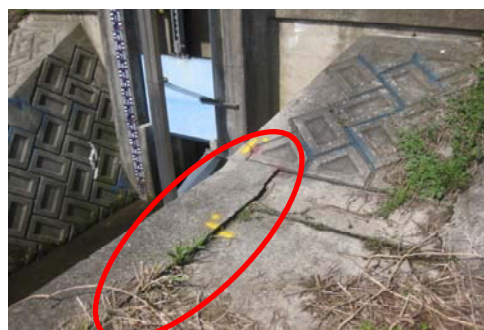
取り付け護岸の段差発生状況
