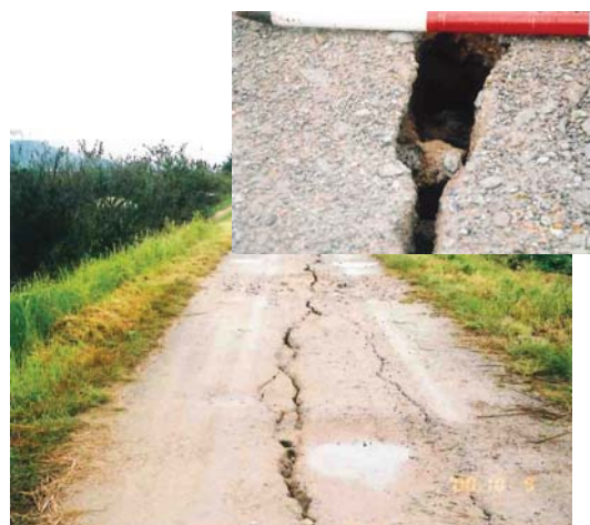
鳥取県西部地震(平成 12 年)による 堤防被災状況(法勝寺川)
