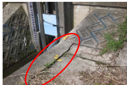
取り付け護岸の段差発生状況
