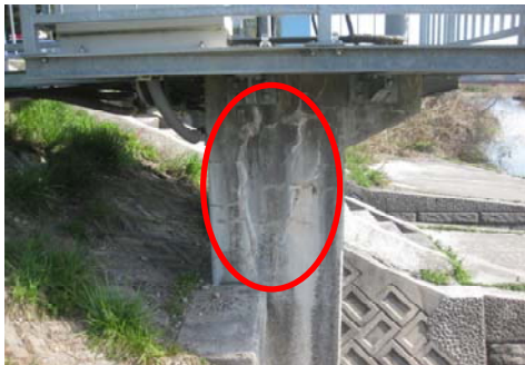
樋門門柱のクラック発生状況
