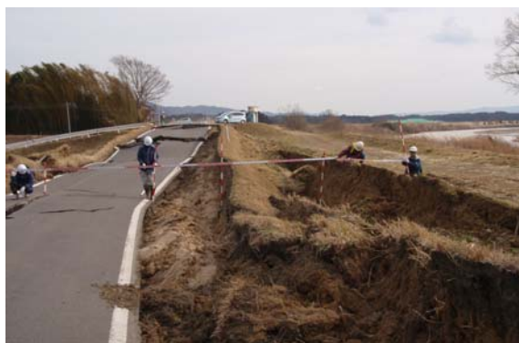
堤防沈下の事例（阿武隈川坂津田地区）
