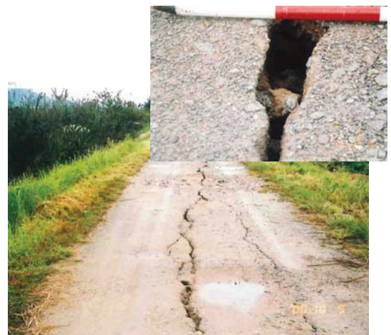
鳥取県西部地震（平成 12 年）による堤防被災状況（法勝寺川）
