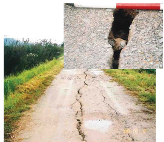
図 2.1.7 鳥取県西部地震による堤防被災状況（法勝寺川）
