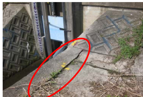
22 取り付け護岸の段差発生状況
