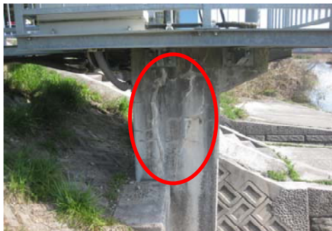
21 樋門門柱のクラック発生状況
