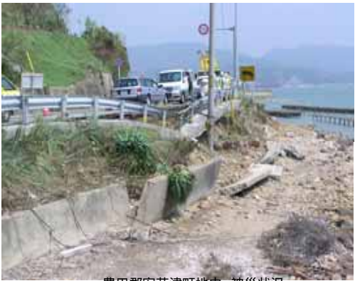
豊田郡安芸津町地内 被災状況
