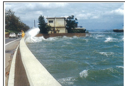
図10-2 越波による路面冠水 (一般国道2号 三原市下木原)
