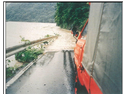
図10-3 洪水による路面冠水 (一般国道375号 三次市作木町)
