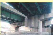
耐震対策の実施状況
