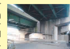
耐震対策の実施状況
