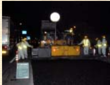
アスファルト材料を敷きならしています 場所：(国道2号) 広島市南区出汐付近
