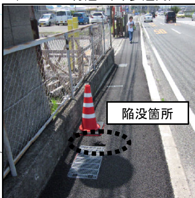
写真①：歩道路面陥没状況 (322K020付近 下り歩道内)
