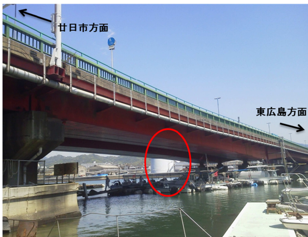
落下した箇所
