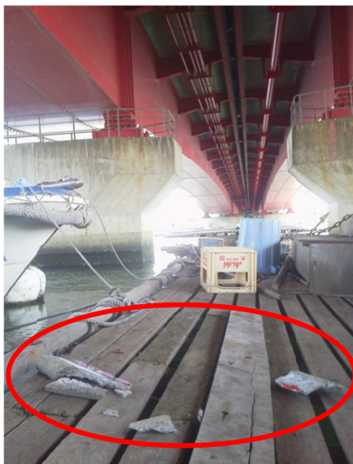
落下したコンクリート片
