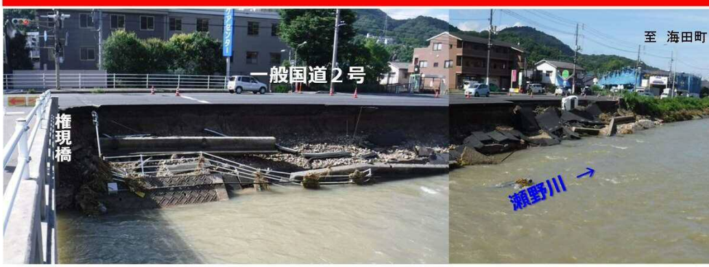
撮影方向 A 被災状況 【平成30年7月9日撮影】
