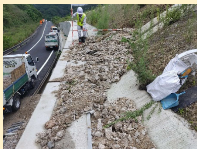
法面土砂流出箇所の緊急点検 (広島市安芸区：東広島バイパス)
