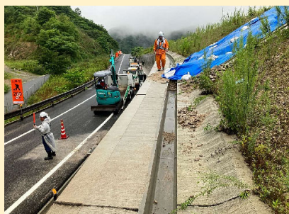
法面土砂流出箇所の応急対策 (広島市安芸区：東広島バイパス)
