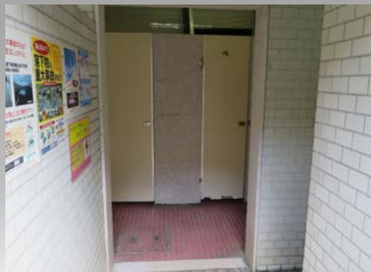
全体的な老朽化や暗い室内 トイレの扉なども損傷
