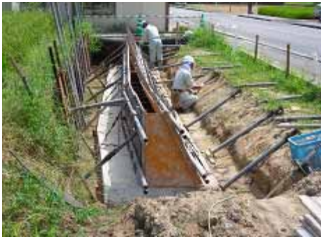
ようへき 擁壁をつくっています (主)安芸津下三永線沿い)
