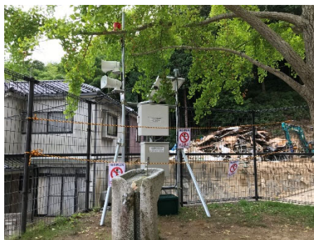
土石流警報装置設置状況
