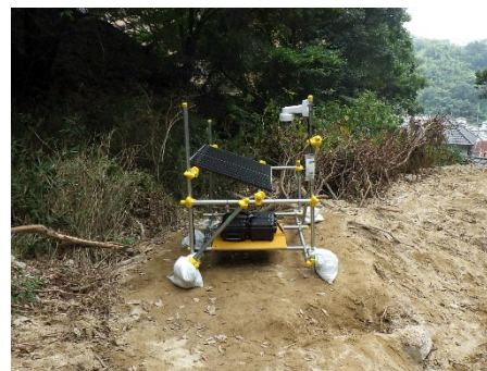
監視カメラ設置状況
