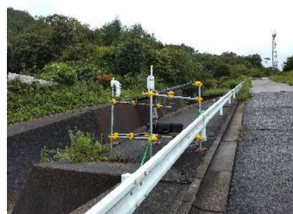
監視カメラ設置状況
