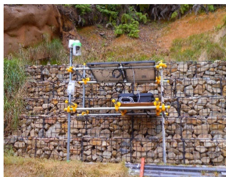
監視カメラ設置状況
