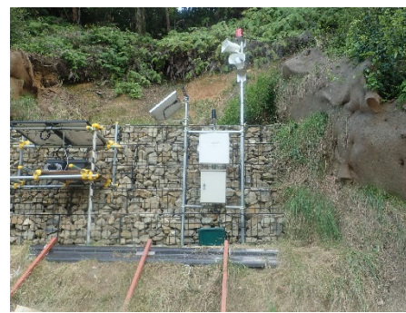
土石流警報装置設置状況
