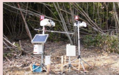
土石流警報装置(18箇所)
