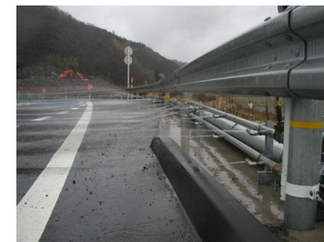
散水融雪設備
