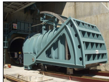
ダム水位維持ゲート設備
