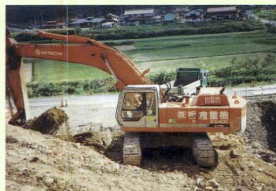
土を掘ったり、積み込んだり、 法面(斜面)を整えたりします。
