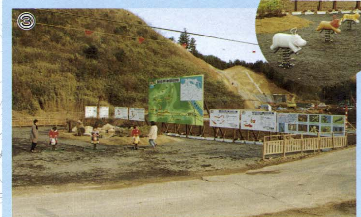
B谷の工事現場手前に建設工事の内容を説明する広場があります。ここから開削部の工事の一部を見ることもできます。
