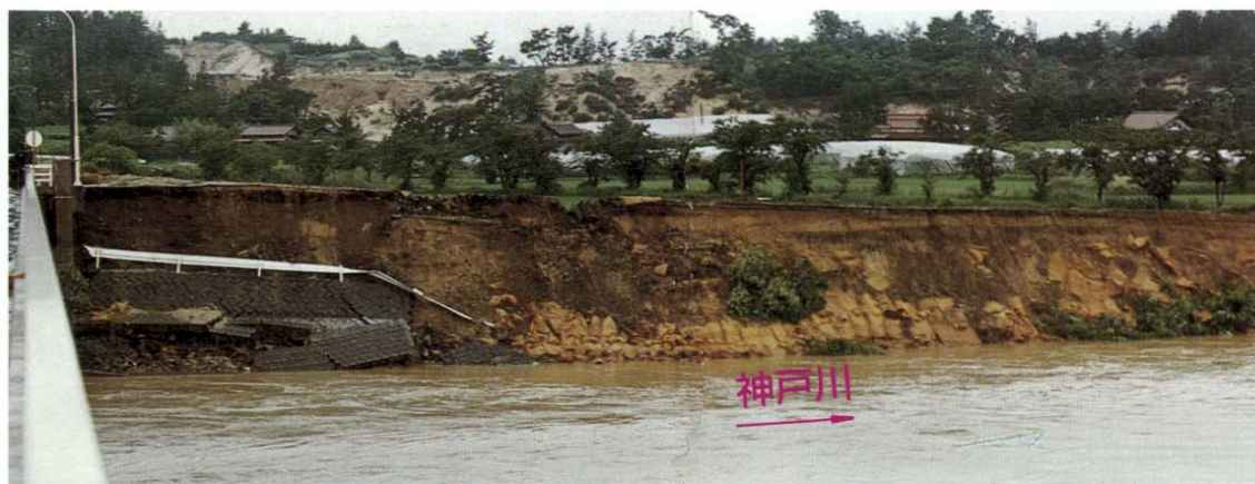
昭和47年7月 出雲市西園町地内 妙見橋下流被災状況
