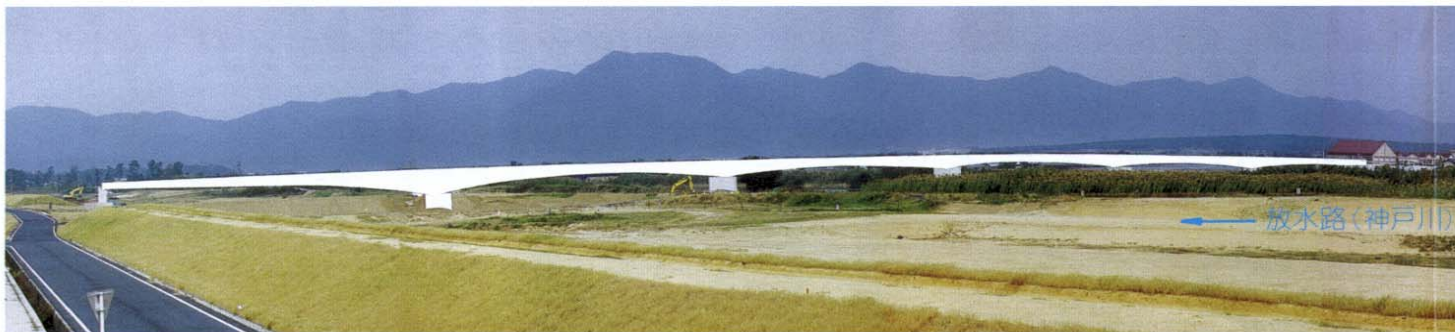
このあと高欄、舗装、照明などの工事を行って、崎屋橋が完成します。
