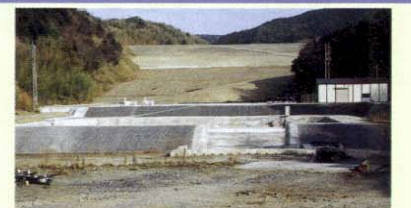
A谷では工事用道路が完成し、防災調整池を施工しています。 B谷では開削部の掘削工事などの残土処理を行っています。 C谷では市道の切替工事が完了し、防災調整池を施工しています。また工事用道路の工事に着手しました。
