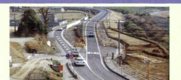
清水前橋の改築工事が完了し、引き続き国道184号の付替工事を進めています。また、清水前橋の取付道路工事に着手しました。
