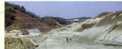
半分地区～菅沢地区の右岸上部掘削(55号参照)、右岸堤防部の盛土工事が完了し、B谷～C谷の左岸上部の掘削工事、大津地区の市道付替工事に着手しました。
