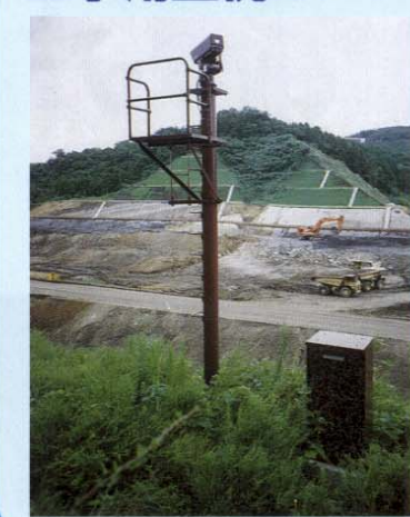
工事用監視カメラ
