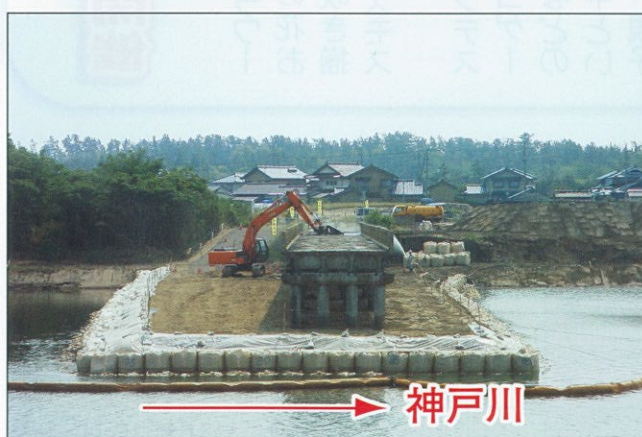
橋の撤去は、東側（一期施工）と西側（二期施工）に分け、解体工事を行いました。
