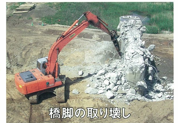
③橋脚をコンクリート破砕機で取り壊します。取り壊したコンクリートは骨材に再生し、有効利用します。
