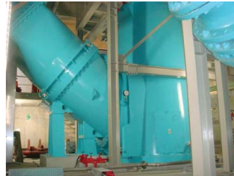
増設されたポンプ
