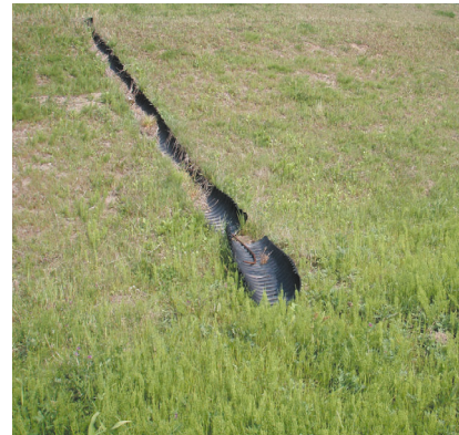
5班:排水施設の破損
