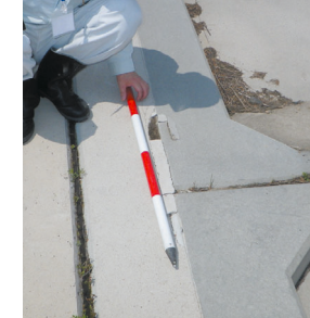
6班:コンクリート剥離
