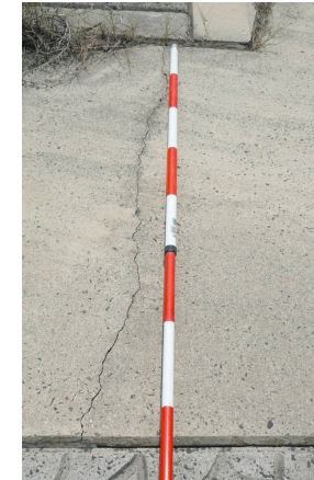
2班:法面のクラック
