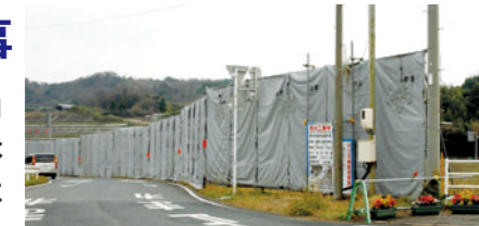
現場周辺への防音・振動対策として、防音柵の設置と騒音・振動計による数値表示を行っています。
