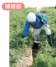
法面浸食状況
