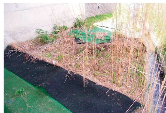
4班:防草シート剥離
