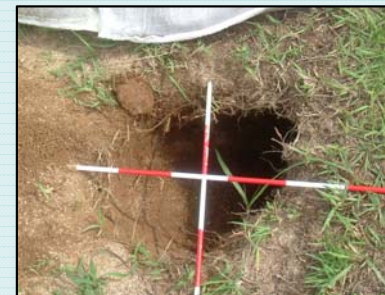
堤防に開けられた小動物の巣穴
