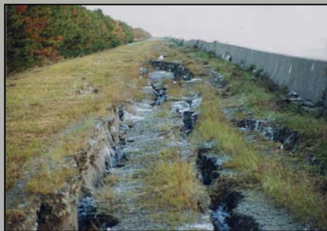
被災状況写真（鳥取県境港市弓浜干拓地先）
