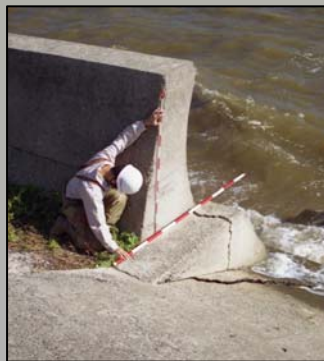
被災状況写真（宍道湖西岸平田地区）
