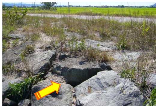
護岸に大きな隙間がある
