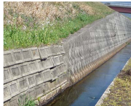
ブロック積擁壁の変形(突出)状況
