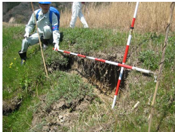
堤防法面の崩落確認状況
