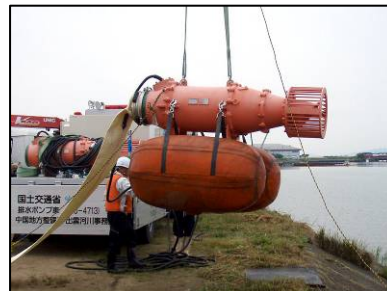
ポンプ設置状況
