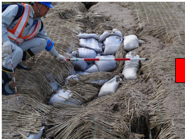
堤防点検での確認状況（法面の浸食）
