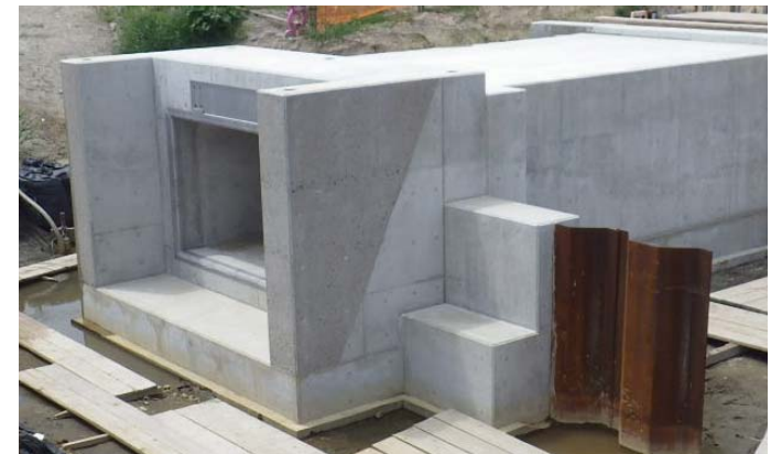
樋門コンクリート面表面を洗い出し処理により明度を落とした（福富地区）
