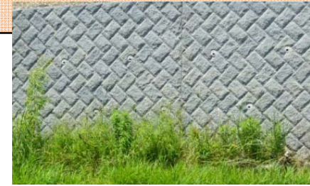
伸縮目地が護岸表面に露出していない状況
