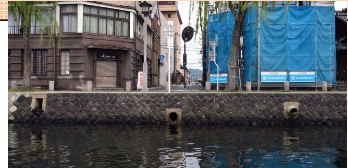
無造作に取り付けられた排水口（大橋川）
