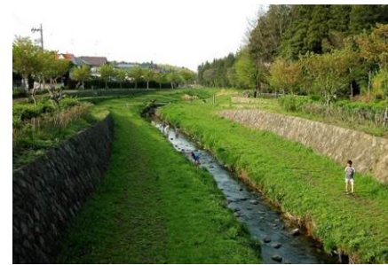
写真1 天端コンクリートを打たずに土で埋戻し、植栽で和らげている事例
